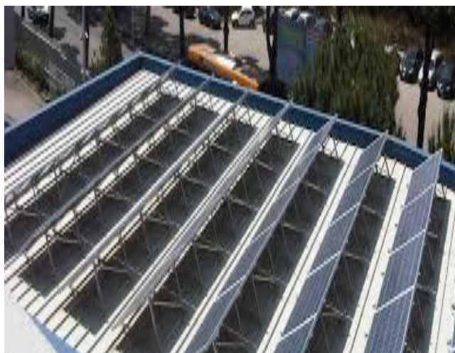
Impianto su tetto con supporti 120 Kw ISET Srl - Valle di Maddaloni
